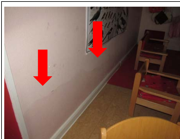
Ergeschoss (exemplarisch) Außenwand Nordseite Feuchtigkeitsschäden (Anstrichverfärbungen) an der Außenwand
