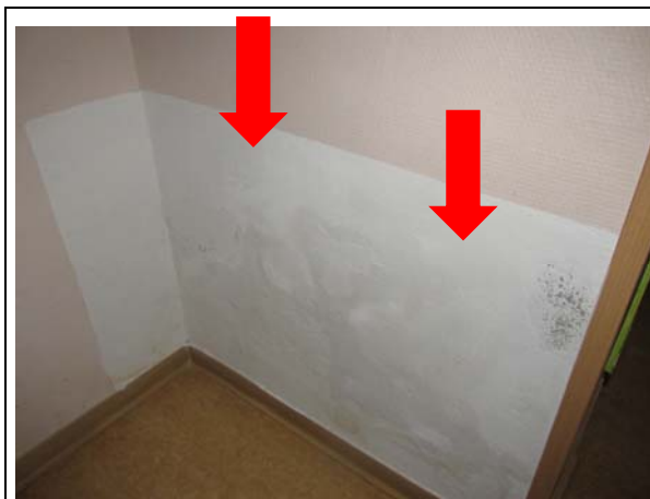
Ergeschoss (exemplarisch) Innenwand über dem nicht unterkellerten Bereich Feuchtigkeitsschäden (putz- und Anstrichabplatzungen) an der Innenwand
