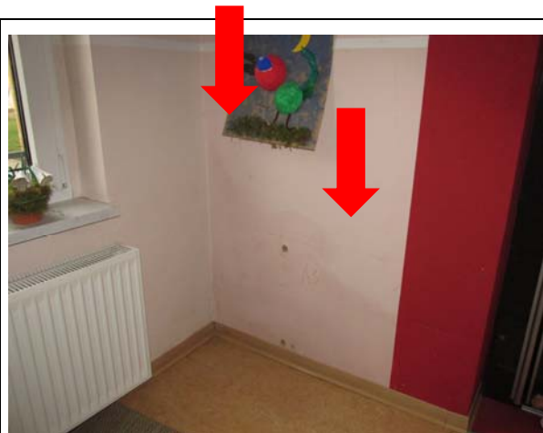
Ergeschoss (exemplarisch) Außenecke Nord-West Feuchtigkeitsschäden (Anstrichverfärbungen) an der Außenwand
